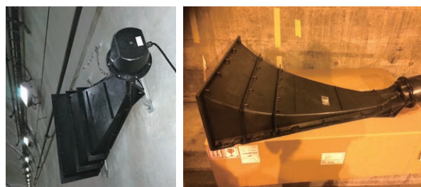
トンネル専用スピーカー
